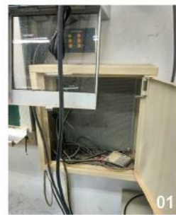
01 教室講台的損壞
